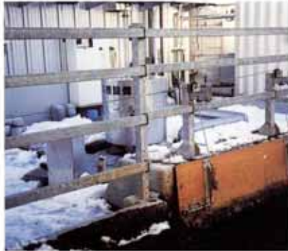
フリーストール牛舎よりローダーで糞尿を直接受入槽に投入する。 (手前のコンパネの扉があがり投入する。 受入槽はコンクリート製30m 3 )
