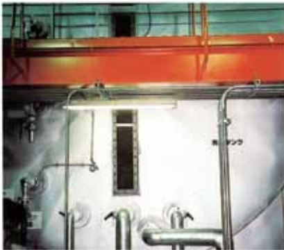
250m 3 (1ヶ月貯留) の発酵タンク (施設内よりタンクの発酵状況がみえる 窓を設置している・近づくると気泡 (ガス) が上昇するのがわかる)
