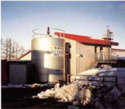
バイオガスプラント全景 (高温域による処理) 60m 3 の発酵槽
