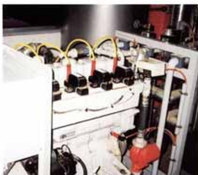
ガスエンジンによる発電装置 (ディーゼルエンジンの発電装置も併設 している)
