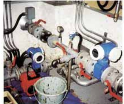
受入槽から発酵槽へスラリーを送るポンプ (手前でプラント処理熱を利用して熱交換を行いスラリーの高度を高くして投入する)
