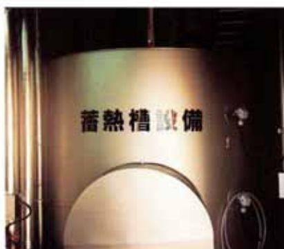
バイオガスプラントで発生した熱をためているタンク (この熱を温水やスラリーの熱交換に利用している)
