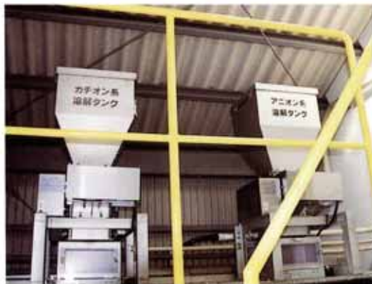
凝集剤混入装置
