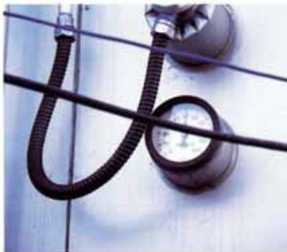
60m 3 発酵槽の温度計 (50℃を示している)
