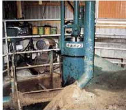
各牛舎からのスラリーを集め圧送ポンプ で処理プラントへ送る
