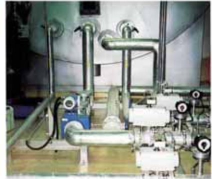
集めたスラリーを発酵槽へ送る移送ポンプ
