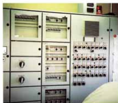
デンマーク製の制御盤 (現在日本でも開発がされている)
