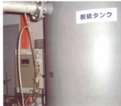
発生したバイオガス中の有毒な硫化水素 を処理する (鉄触媒による化学的処理)
