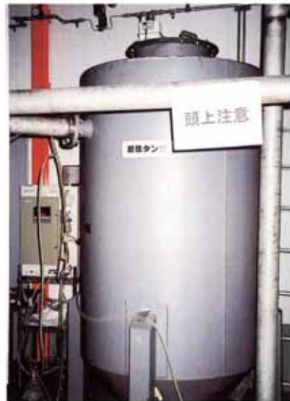
硫化水素を処理する (生物処理) タンク
