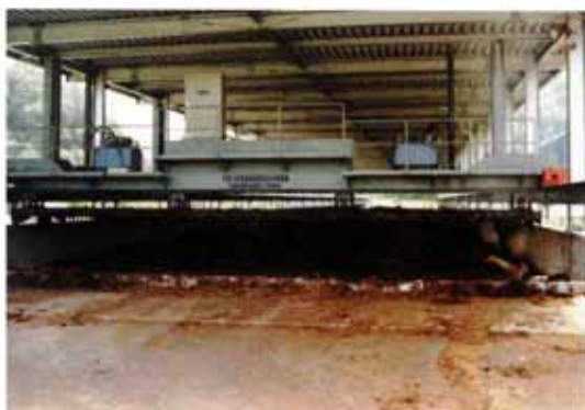
投入口とクレーン方式の攪拌処理機械
