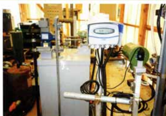
運転管理に重要なPH計も設置している
