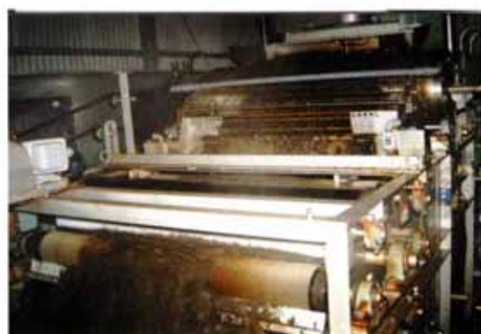
脱水機による余剰汚泥の脱水
