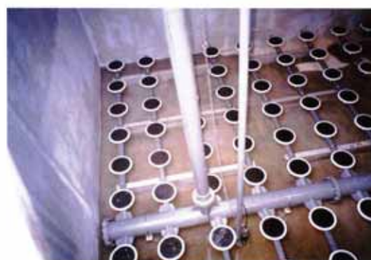
回分凝集槽内部 (運転開始前のディフューザー通気管)
