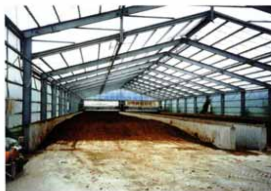
攪拌発酵槽投入口（深さH=800・2レーン）
